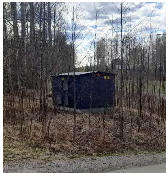
Kuva 25. Koivistonkyläntien ja koulun liittymän vierellä on sähkömuuntaja.
