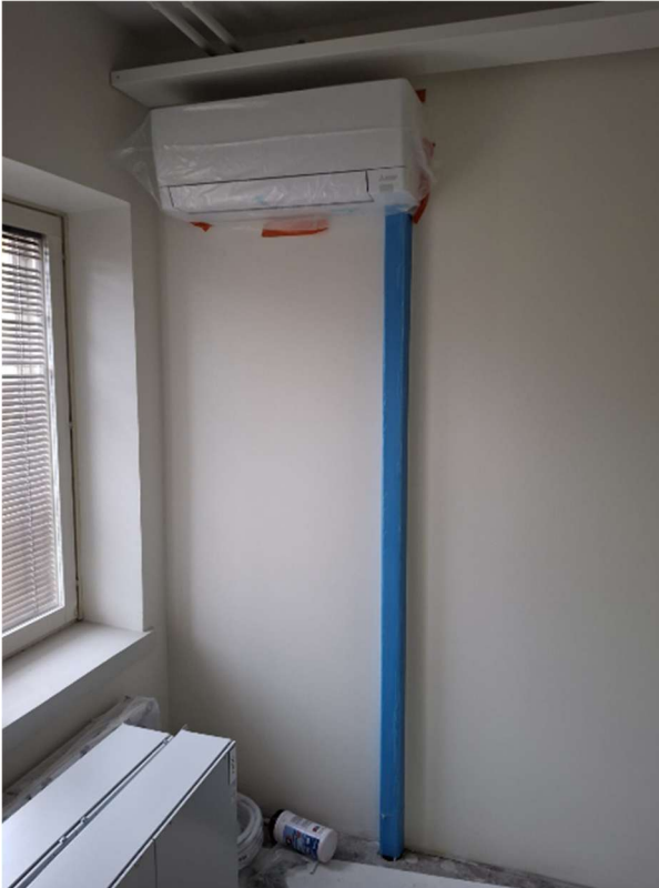
Jäähdytyksen sisäyksikkö paikallaan ensimmäisessä kerroksessa.
