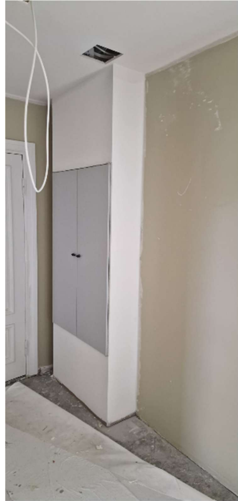
Sähkökaappi on koteloitu kipsilevyllä, tasoitettu ja pohjamaalattu. Katossa reikä tarkastusluukku varten.
