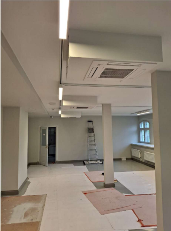
Kattoasenteiset jäähdytyksen sisäyksiköt paikallaan ja koekäytettynä.
