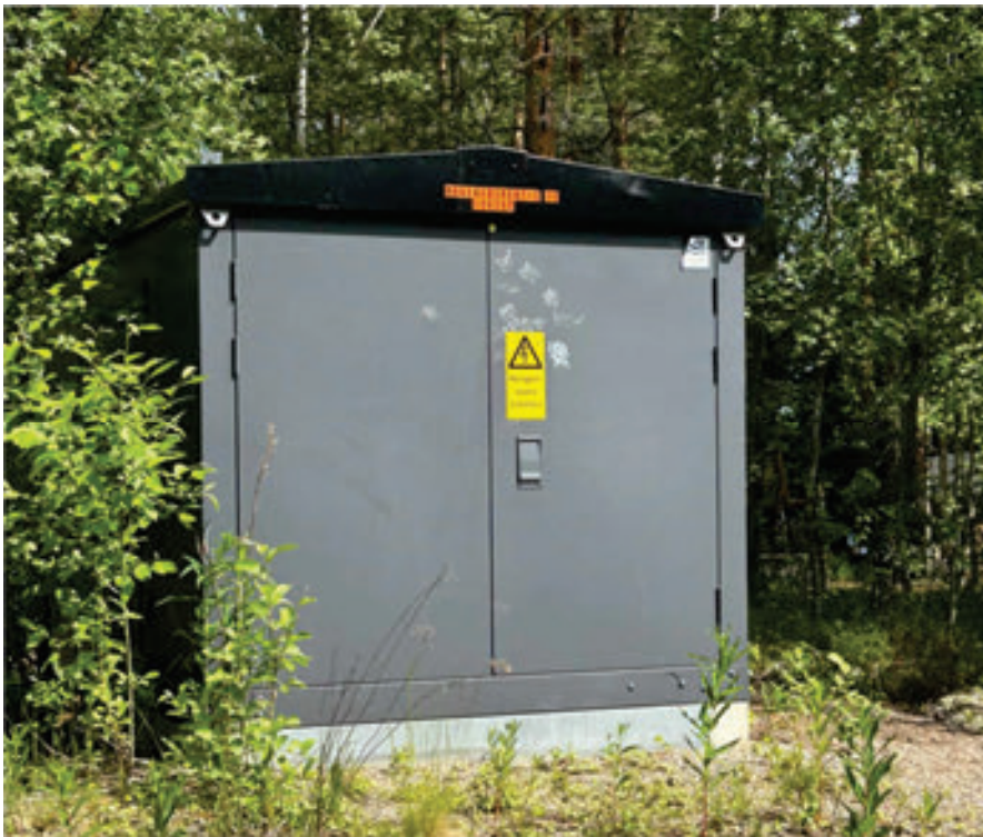
Kuva 26. Puistomuuntaja pohjavesialueen pohjoisosassa.
